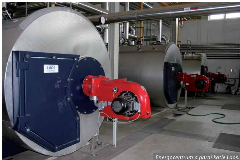
Energocentrum a parní kotle Loos.
