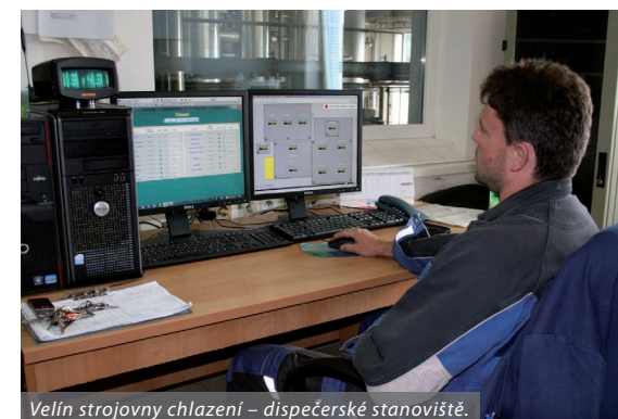
Velín strojovny chlazení – dispečerské stanoviště.
