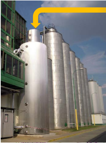
Nádrž na energetickou vodu
