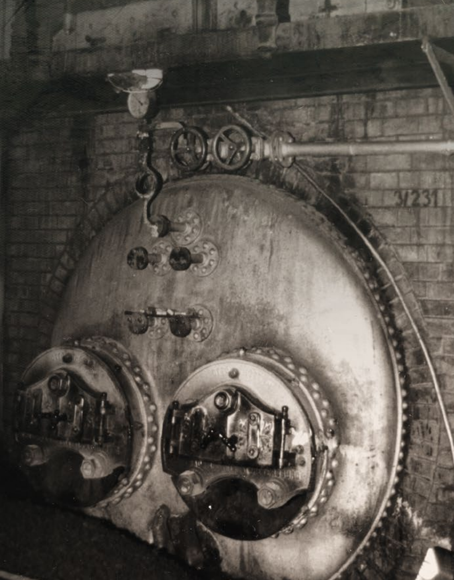
KOTELNA PIVOVARU VE VYSOKÉM CHLUMCI NA SEDLČANSKU V PLNÉM PROVOZU NA SNÍMKU PAVLA JÁKLA V ROCE 1986. SPUDNÍ DVOJPLAMENOVÝ KOTEL OD SASKÉ FIRMY OTTO THUST, ZWICKAU, PARIS, ST. PETERSBURG BYL INSTALOVÁN ROKU 1942 A VRCHNÍ VÝMĚNÍK RINGHOFFEROVOU STROJÍRNOU ROKU 1908. KOTELNA BYLA V PROVOZU DO KONCE TISÍCLETÍ A DLE SDĚLENÍ PAMĚTNÍKŮ MUSEL TOPIČ VYVINOUT TANEČNÍ AŽ AKROBATICKE UMĚNÍ, ABY VE STÍSNĚNÉ KOTELNĚ VHDOL UHLÍ CO NEJÁLE DO KOTLE.
