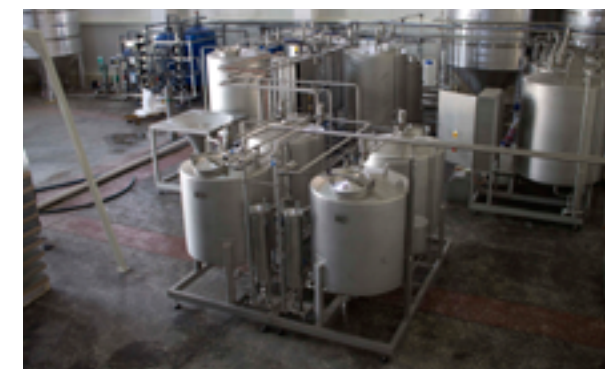
Pohled na kompletní technologii výroby sirupů a CIP stanice
